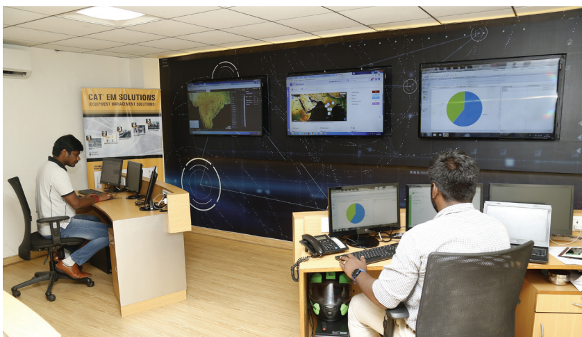
EM Solutions Control Room, Chennai.
